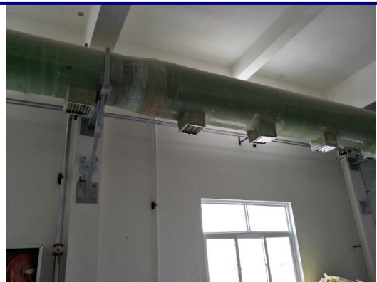
暂存库集气管道
