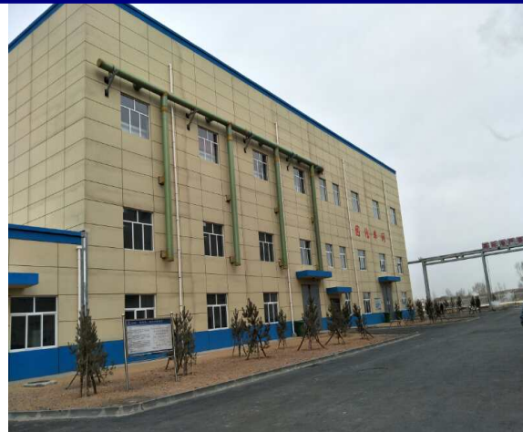
固化车间废气集气管道
