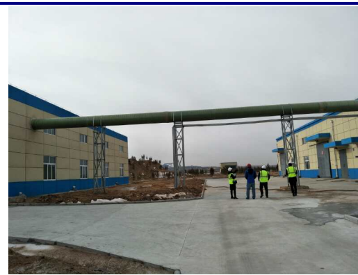
暂存库集气管道
