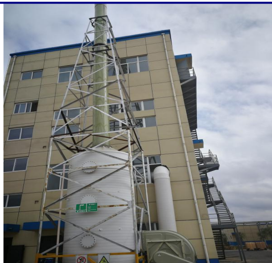
物化车间净化处理系统
