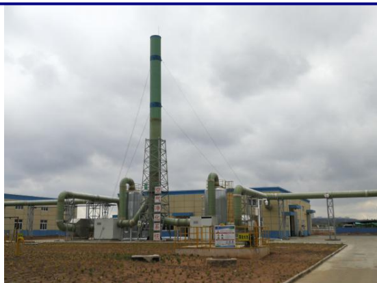
暂存库空气净化装置
