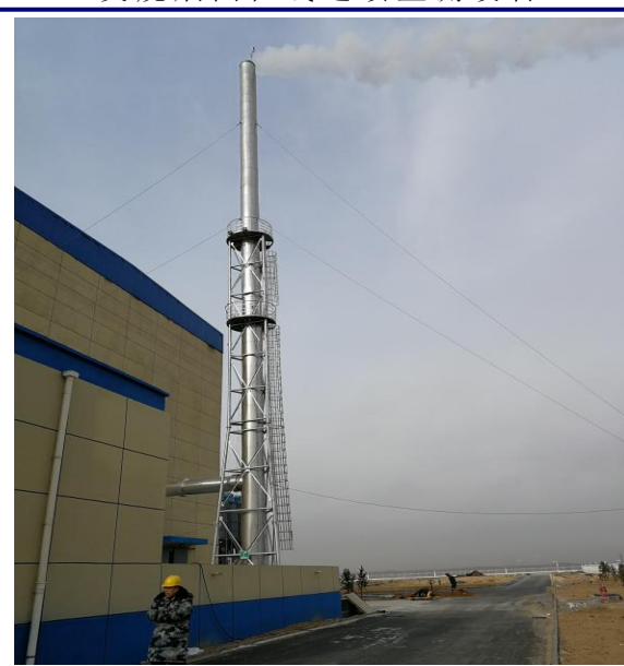
焚烧炉烟气排放烟囱
