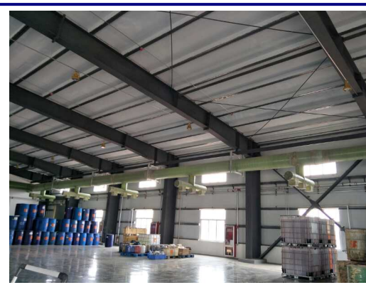
暂存库集气管道
