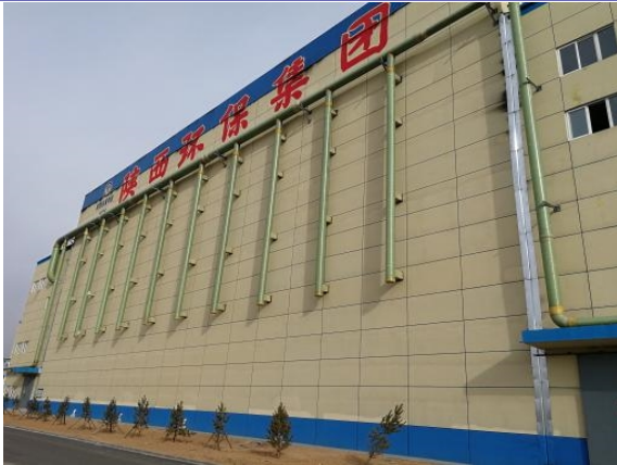
焚烧车间废气收集管道
